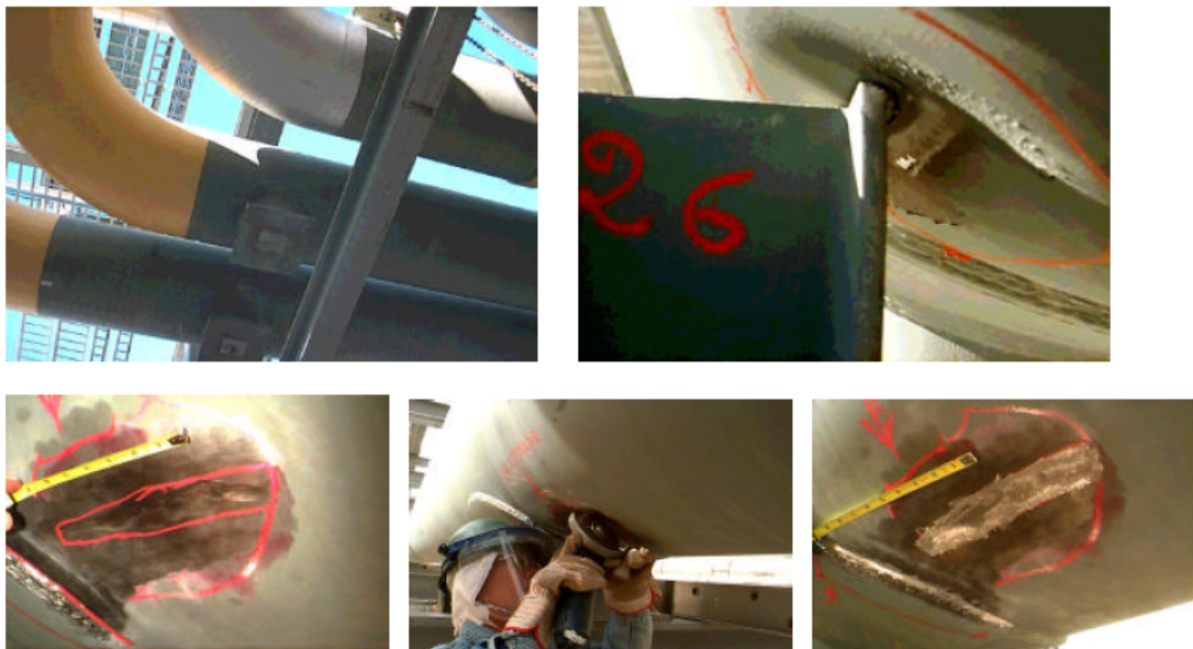
شکل ۶- صدمات مکانیکی روی pipe rack و تعمیر با سنگ زدن
